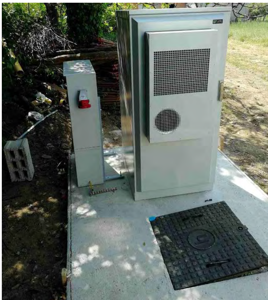
Slika 3.1. Izgled projekta (kabinet za potrebe fiksne telefonije i ormar za elektronapajanje)
