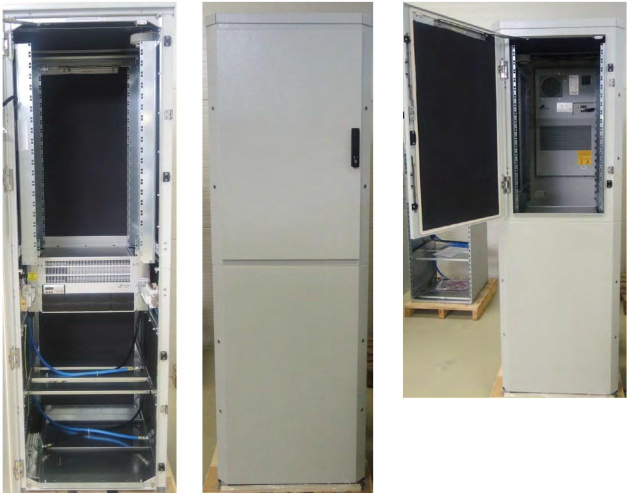
Slika 3.2. Spoljašnji i unutrašnji izgled outdoor kabineta
